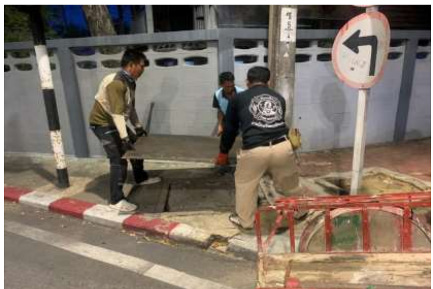
ภาพ ฝาท่อชำรุด นำแผ่นเหล็กปิด ไว้ชั่วคราวรอดำเนินการแก้ไข
